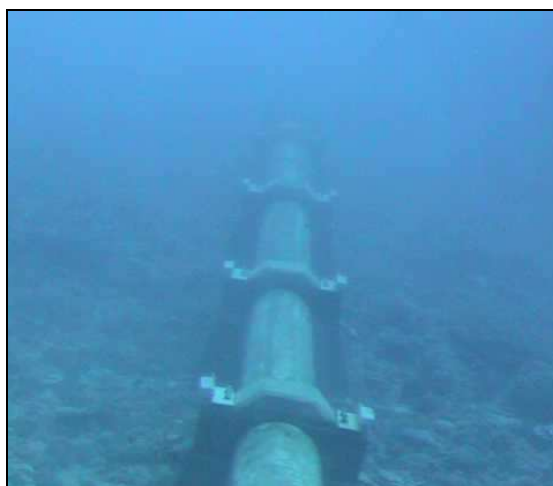
Figure 5 : Photo sous marine de la conduite (40cm de diamètre, de l'hôtel de luxe à Bora-Bora, lestée sur le fond à 45 m de profondeur, pompant de l'eau à 5,5°C à 900m de fond
