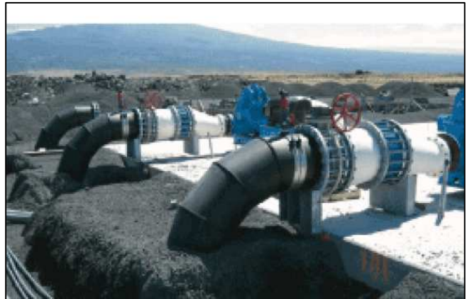
Figure 3: Photo d'une station de pompage à Hawaï
