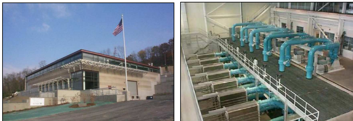
Figure 30 : Photos extérieure et intérieure de la station d'échange de l'Université de Cornell (référence 13)
