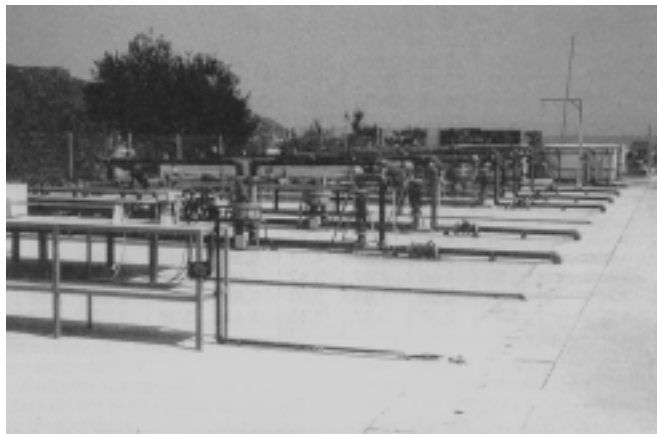
Vue de la boucle d'essais en eau de mer réalisée au Centre Ifremer de Brest pour l'étude des phénomènes de corrosion et de salissures marines dans les tubes d'échangeurs
